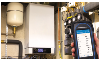
Contrôle annuel de chaudière domestique
