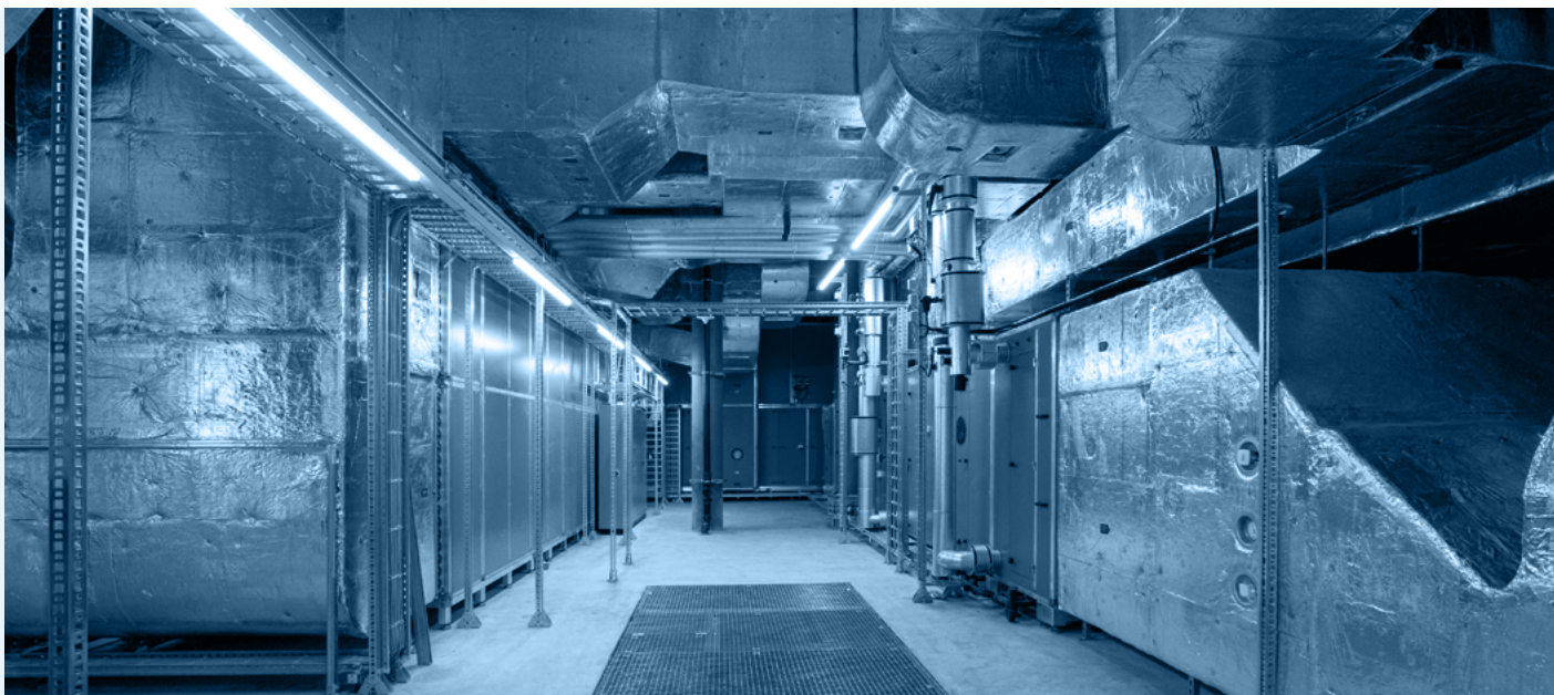
Klimaanlage eines Einkaufszentrums in Zürich - ©balakate/123RF.COM
