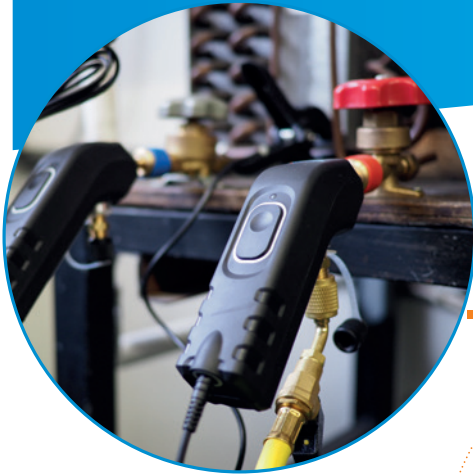
MEDICIÓN EN GRUPO DE REFRIGERACIÓN MEDIANTE EL SI-RM3
